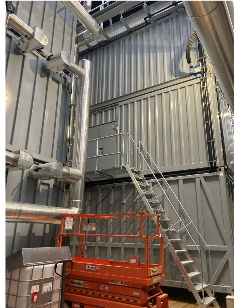
Kälteturm 2: Zuweg Hydraulik Container
